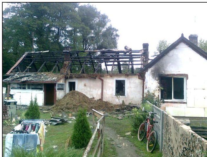
26.08.2012r. - pożar budynku mieszkalnego w Rytwianach, ul. T. Kościuszki.
