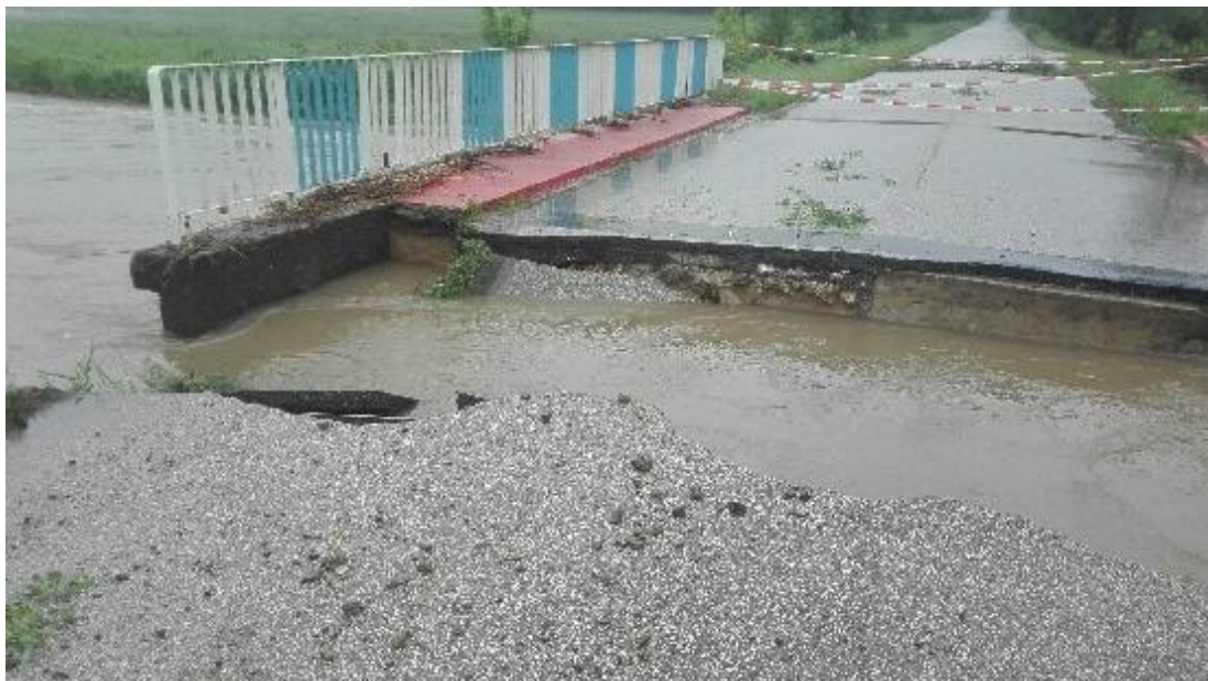
Most w miejscowości Podborek (fot. PSP Staszów)
