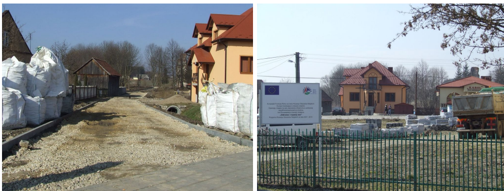
Remont alejki prowadzącej do ruin zamku oraz plac przy budynku UG w Rytwianach (po prawej)
